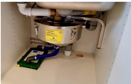
Diskbänksavskiljare med utjämningskärl under vask.
