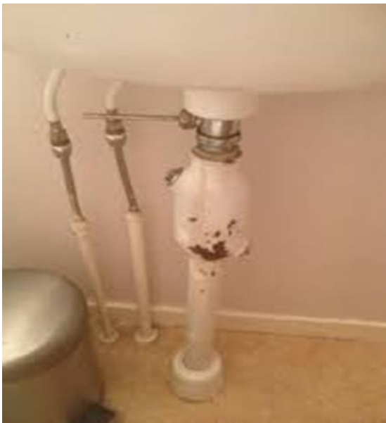
Vattenlås av gjutjärn bör bytas ut mot plast.
