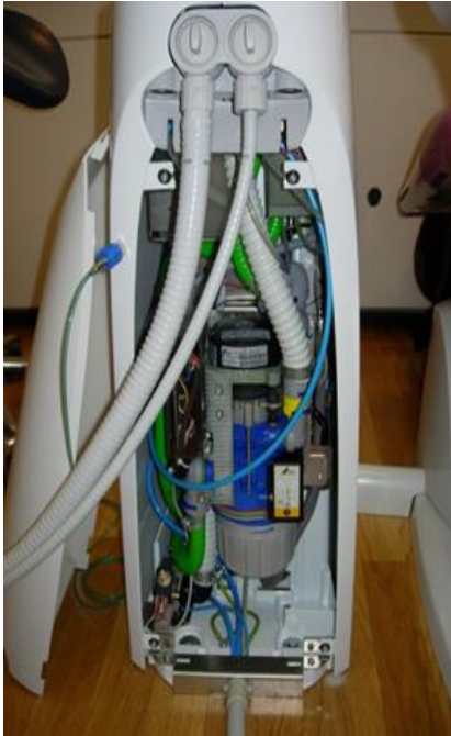
Ex på torrt sugsystem med centrifugerande amalgamavskiljare
